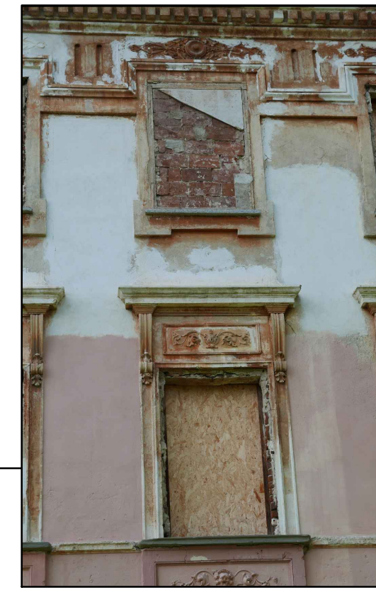
DETTAGLIO FINESTRE ARCHITRAVE E SPALLETTE FINESTRE DEGRADATE
