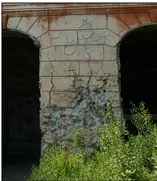
FENOMENI DIFFUSI DI DISTACCO DELL'INTONACO
