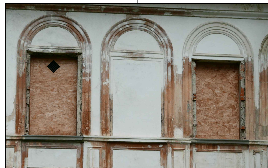
PARTICOLARE SPALLETTE FINESTRE DEGRADATE
