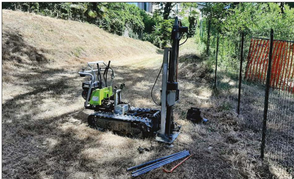
Foto 7: Prova penetrometrica dinamica P7.
