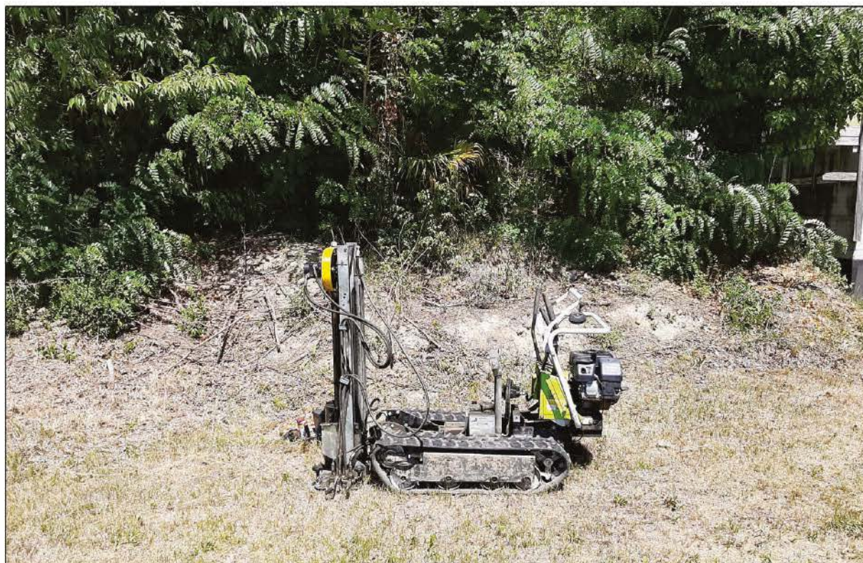
Foto 5: Prova penetrometrica dinamica P5.
