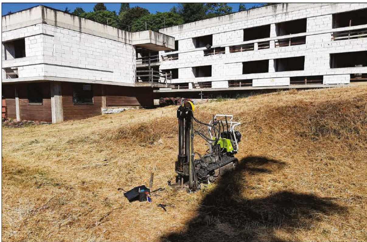
Foto 2: Prova penetrometrica dinamica P2.
