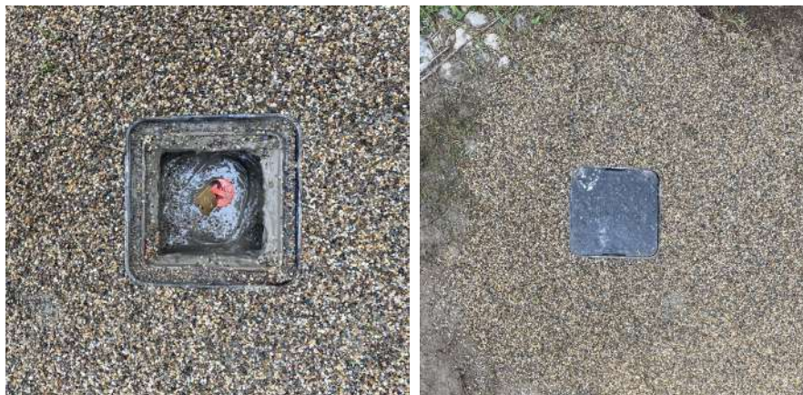
Pozzetto su S2
