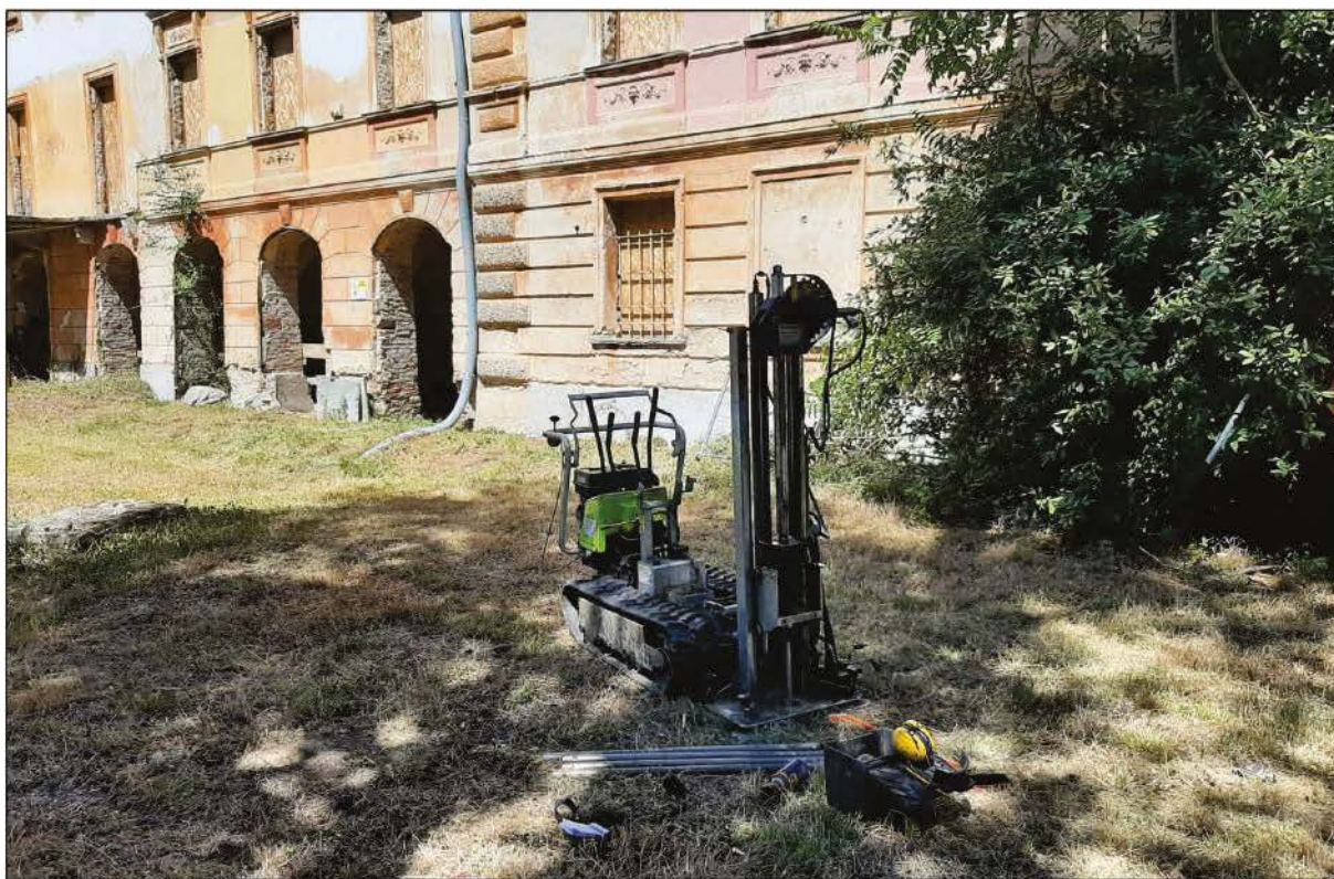
Foto 4: Prova penetrometrica dinamica P4.
