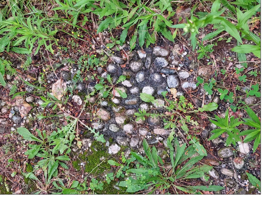
Pavimentazioni storiche danneggiate
