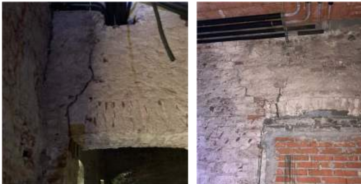
Figura 7 – Interni di Villa Antica – Dettaglio criticità locali – dissesto architravi
