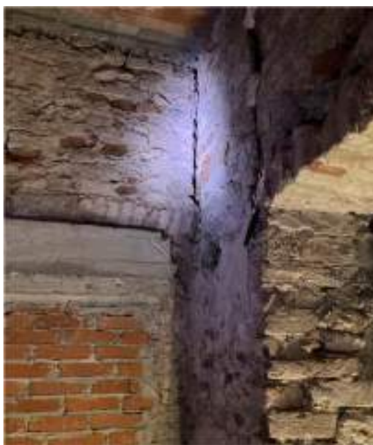
Figura 8 – Assenza di collegamento tra i maschi murari
