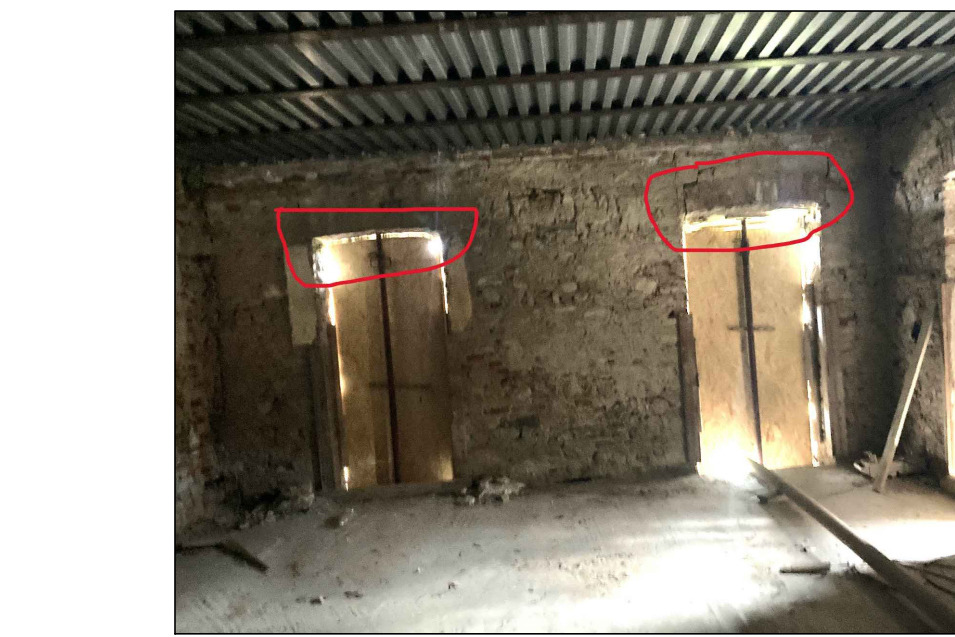
PRESENZA DI DEGRADO NEI VOLTINI E DI FESSURAZIONI IN CORRISPONDENZA DELL'APPOGGIO ALLA MURATURA Recupero dei voltini mediante sigillatura delle fessure e ripristino dell'appoggio alla muratura con eventuale intervento cucu scuci; tamponamento parziale o totale dei vani finestra mediante intervento di ricostruzione della muratura PART. 4
