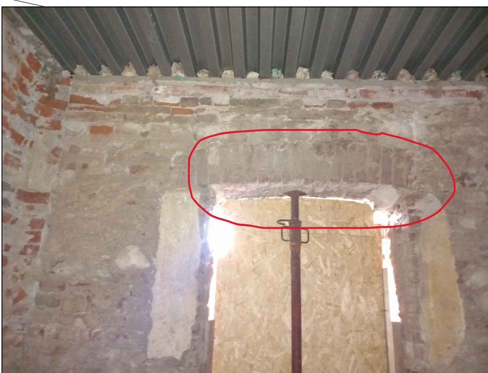
PRESENZA DI DEGRADO NEI VOLTINI Recupero dei voltini mediante sigillatura delle fessure e ripristino dell'appoggio alla muratura con eventuale intervento cucu scuci; tamponamento parziale o totale dei vani finestra mediante intervento di ricostruzione della muratura PART. 4
