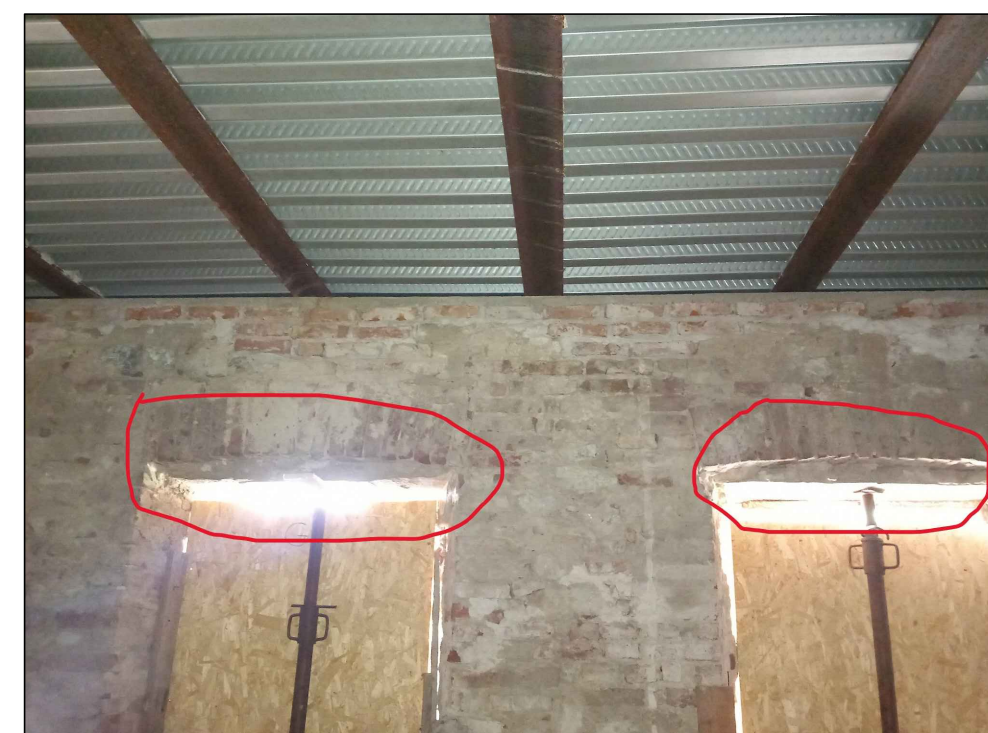
PRESENZA DI DEGRADO DEI VOLTINI Recupero dei voltini mediante sigillatura delle fessure e ripristino dell'appoggio alla muratura con eventuale intervento cucu scuci; tamponamento parziale o totale dei vani finestra mediante intervento di ricostruzione della muratura PART. 4
