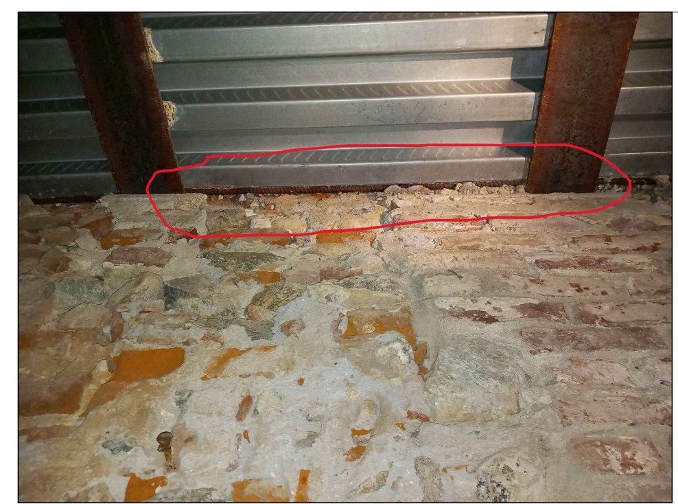
ESPOSIZIONE DI FERRI DI ARMATURA CON TRACCE DI OSSIDAZIONE Risanamento e ripristino delle parti mancanti di calcestruzzo eseguito con malta premiscelata fibrorinforzata, per uno spessore complessivo medio fino a 30 mm, compresi l'asportazione delle parti ammalorate, la pulizia mediante spazzolatura, incluso trattamento dei ferri esistenti con prodotti passivanti
