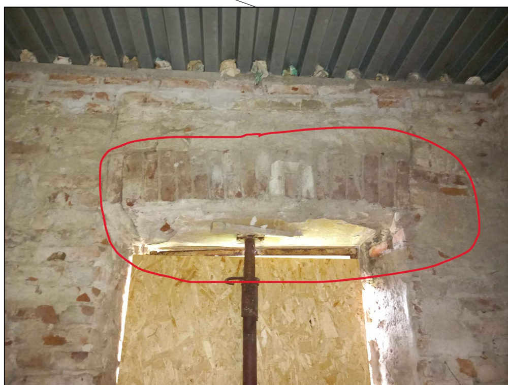
PRESENZA DI DEGRADO NEI VOLTINI E DI FESSURAZIONI IN CORRISPONDENZA DELL'APPOGGIO ALLA MURATURA Recupero dei voltini mediante sigillatura delle fessure e ripristino dell'appoggio alla muratura con eventuale intervento cucu scuci; tamponamento parziale o totale dei vani finestra mediante intervento di ricostruzione della muratura PART. 4
