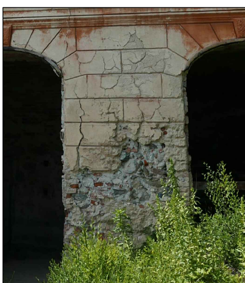
FENOMENI DIFFUSI DI DISTACCO DELL'INTONACO
