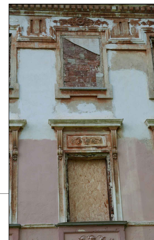
DETTAGLIO FINESTRE ARCHITRAVE E SPALLETTE FINESTRE DEGRADATE
