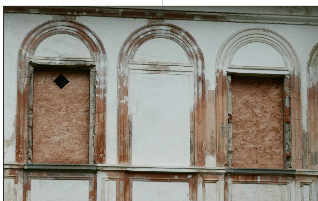
PARTICOLARE SPALLETTE FINESTRE DEGRADATE
