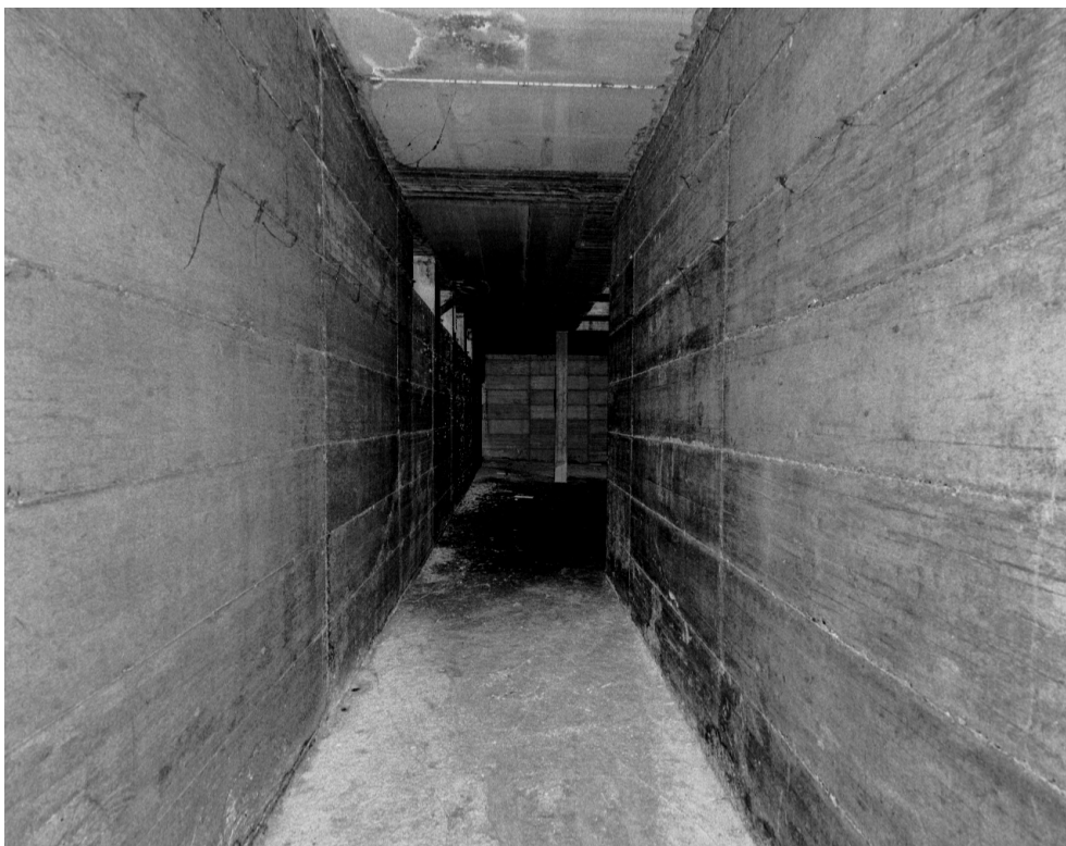
A906 - Corridoio locale tecnico
