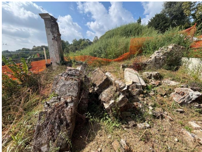
Resti dell'arco dopo il crollo
